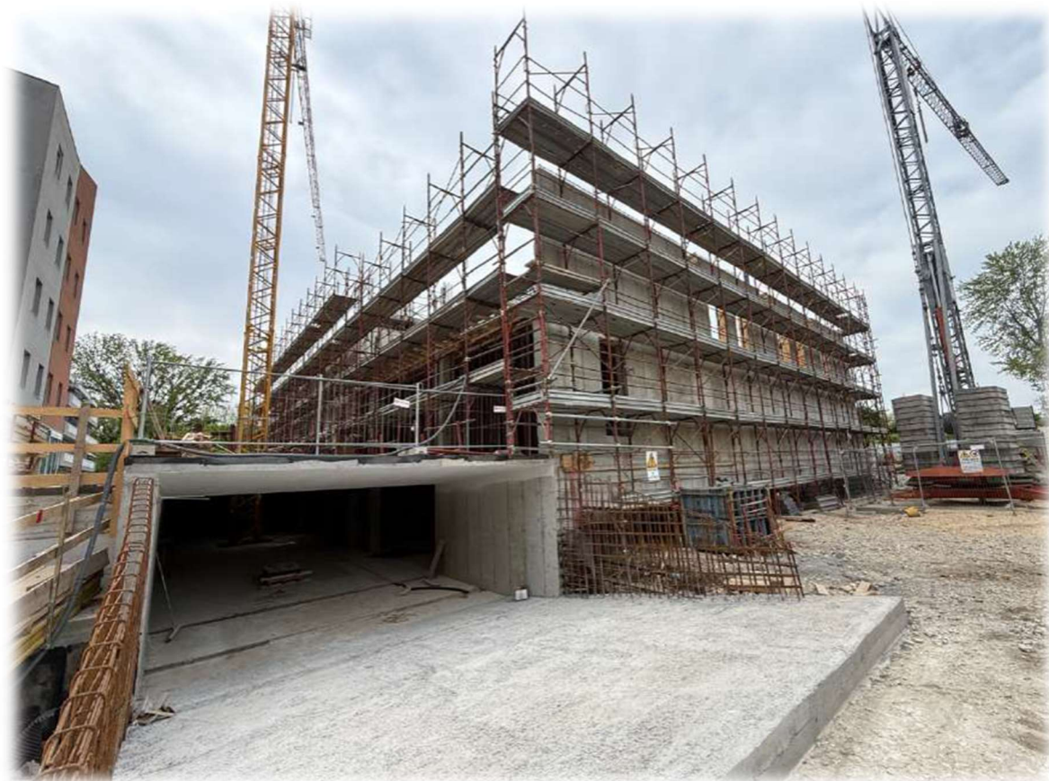
Costruzione della nuova Sede Amministrativa di Rovigo - stato di avanzamento a marzo 2026.
